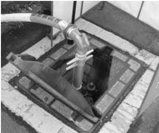
放水体験は学校北側道路上にある防火栓から水を引いて実施。
